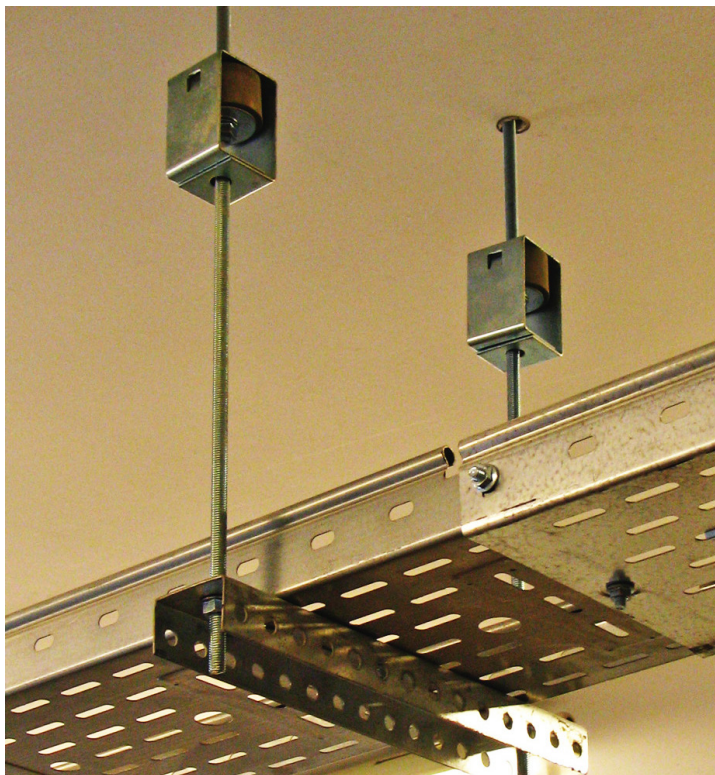
Виброизоляция лотков кабельных сетей
